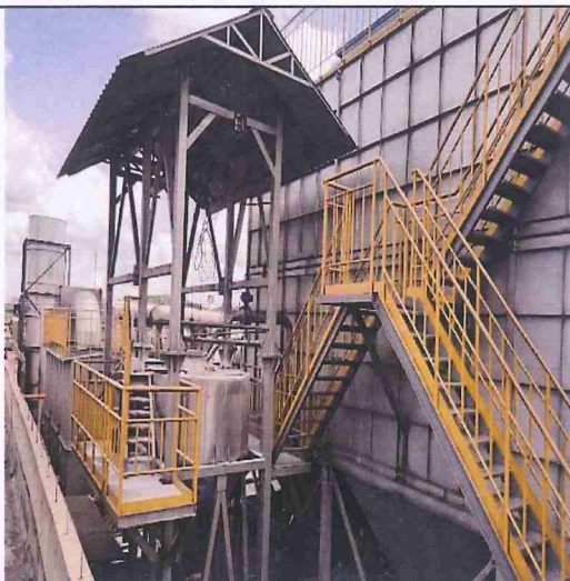
废气处理设备（C区）
