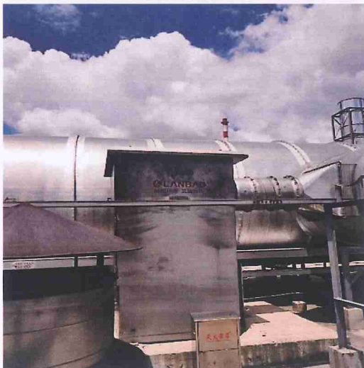
废气处理设备（B区2#）
