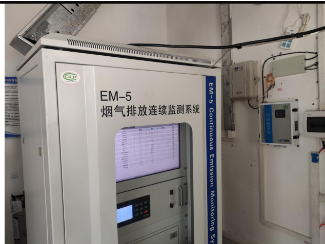
图 7-3 烟气排放连续监测系统
