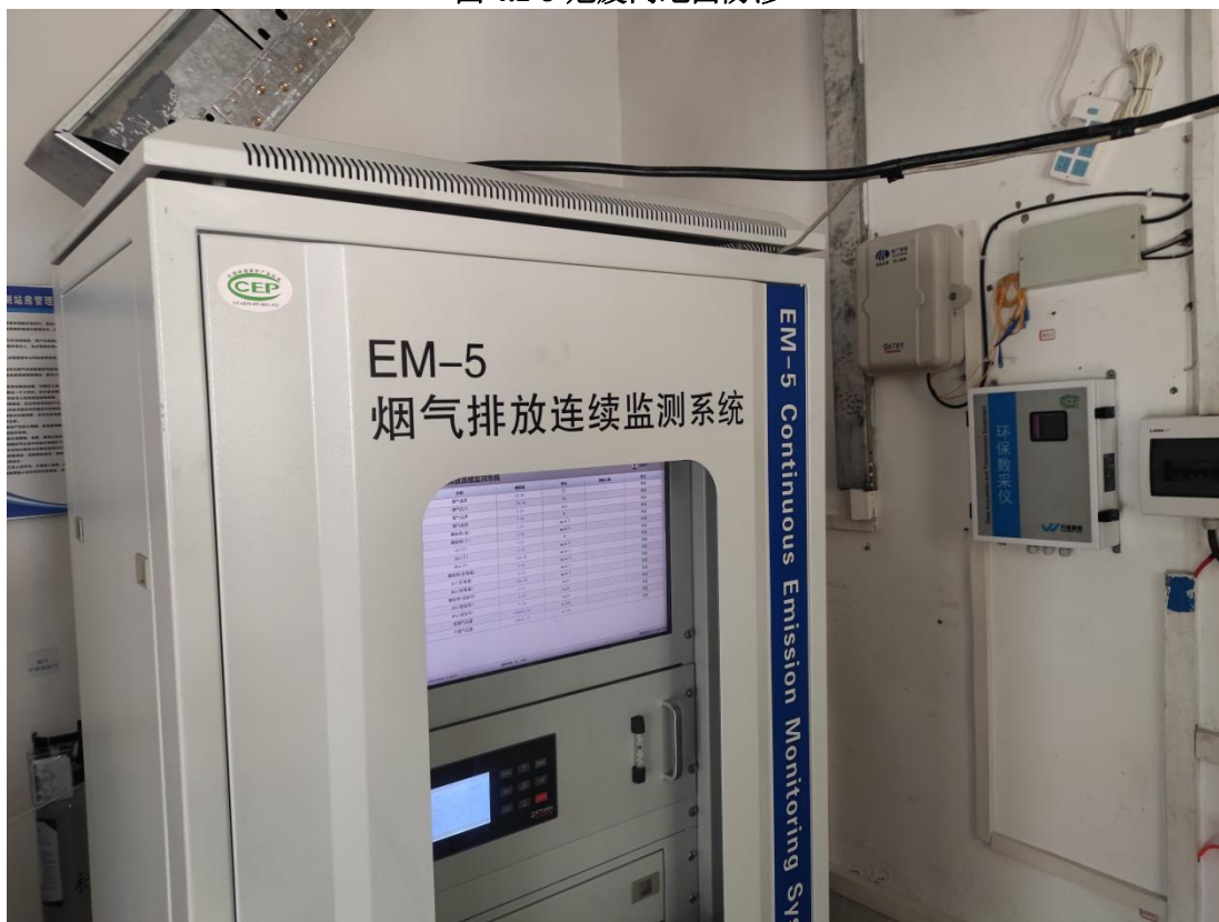
图 4.2-4 锅炉烟气在线监测室
