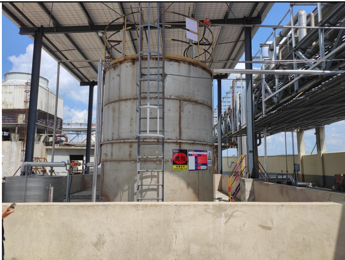
图 4.2-5 氨气罐防护措施
